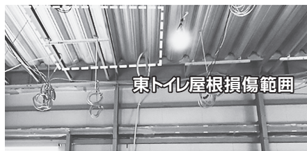
万博協会が認めた天井部分の損傷(写真は万博協会提供)
